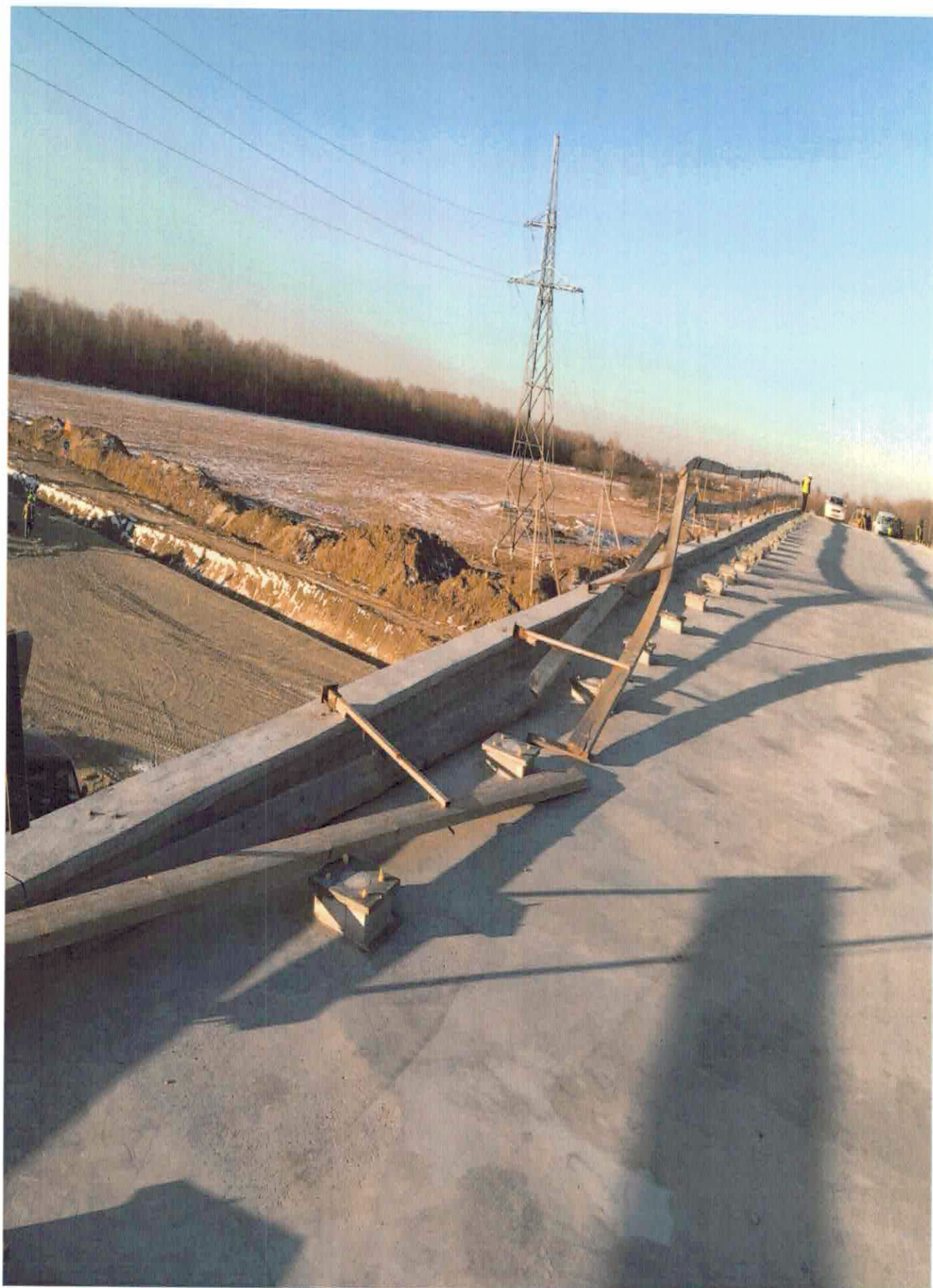
Фото № 2. Частичное отсутствие защитных ограждений на путепроводе ПК 116+42.
